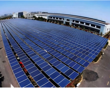
图3 合肥市政务中心光伏车棚
